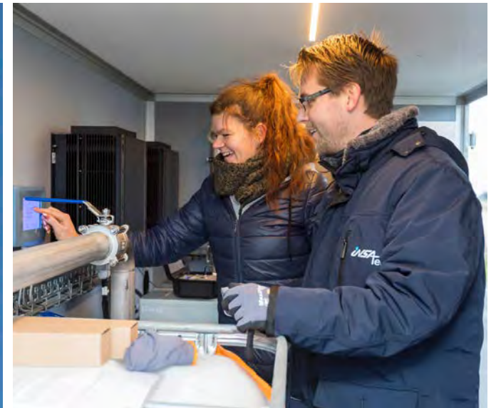
Insatechs egenutvecklade vattenreningssystem RemUVe säkrar att dricksvattnet har hög kvalitet.
