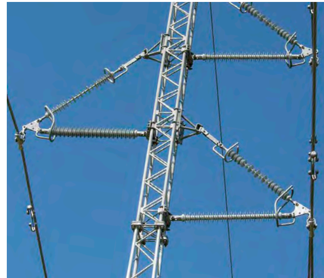
Necks Electrics gitterstolpsystem N14 bidrar till en grönare nätbyggnation och sänker kostnaderna för linjebyggnation.
